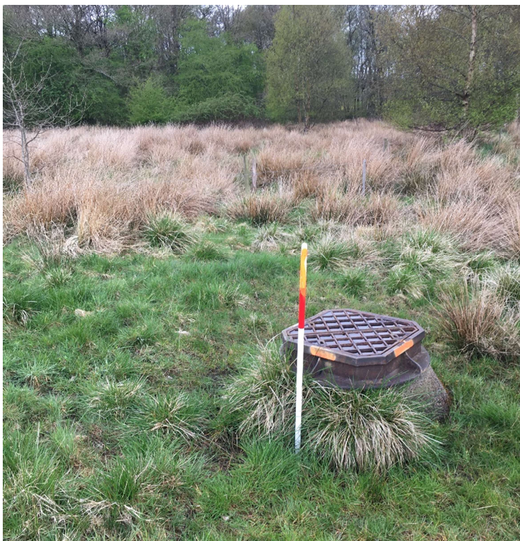
Figur 1. Eksempel på en brønd der skal nedlægges. Når betonkeglen og jerndækslet er fjernet, fyldes hullet op med sand eller grus.
